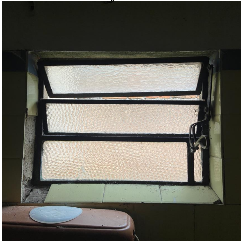
Vista Interna Esquadria Banheiro Sanitário 2 Feminino
