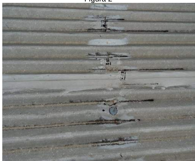
Detalhe Parafuso Existentes com Pontos de Infiltração
