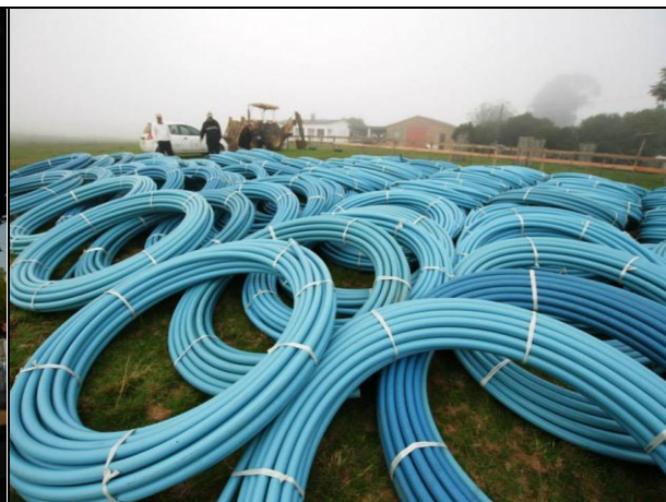
FOTO 06 – Rede de Água/Loc. Tupanci
