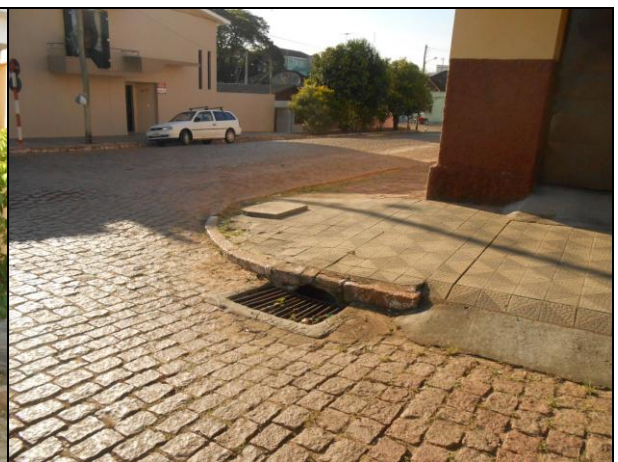
FOTO 04 – Boca de Lobo
