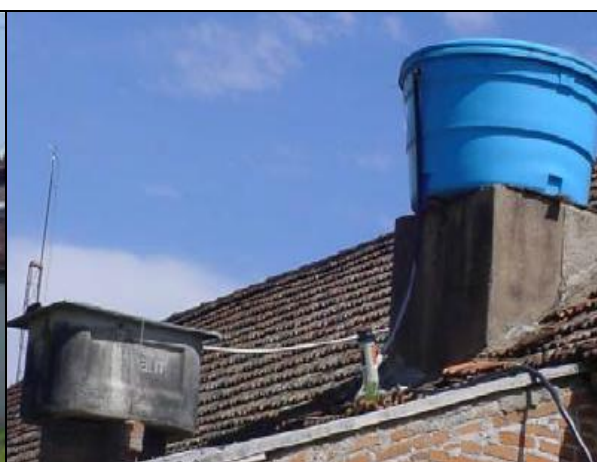
FOTO 06 – Sistema de Armazenamento
