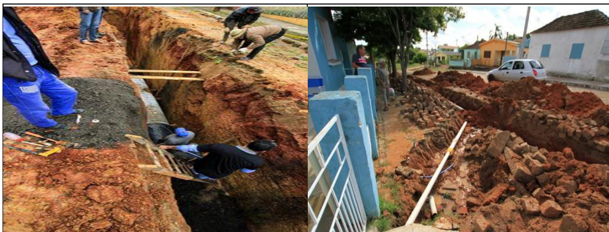
FOTO 01 e FOTO 02 – Infraestrutura/Rede de Esgoto Rua Coronel Veríssimo e Riachuelo
