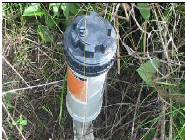
FOTO 03 – Tratamento da água/Dosador
