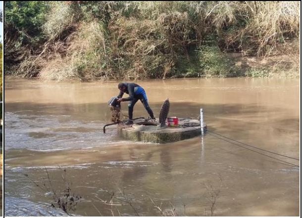
FOTO 02 – Ponto de Captação/Rio São Sepé
