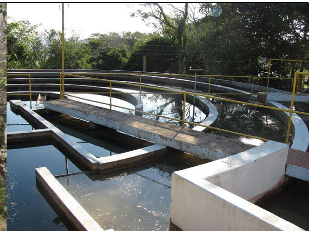
FOTO 04 – Estação de Tratamento
